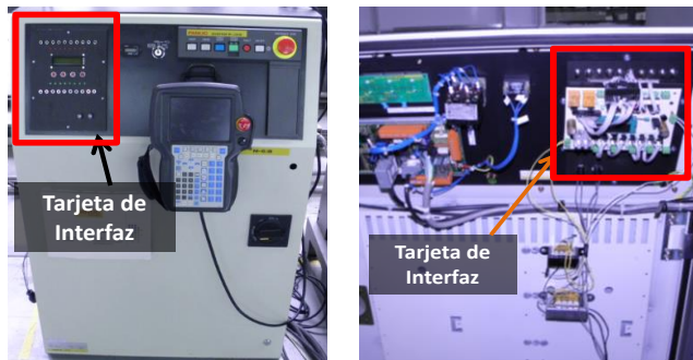
Figura 8 Tarjeta instalada dentro del gabinete del robot Fanuc
