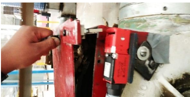
Figura 7 Instalación de sensor Interruptor de límite Fuente: Empresa (caso de estudio)
