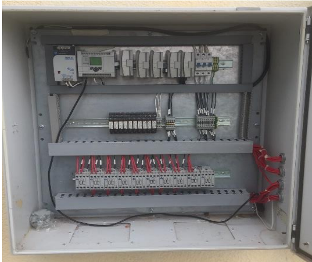
Figura 6 PLC instalado en edificio A5
