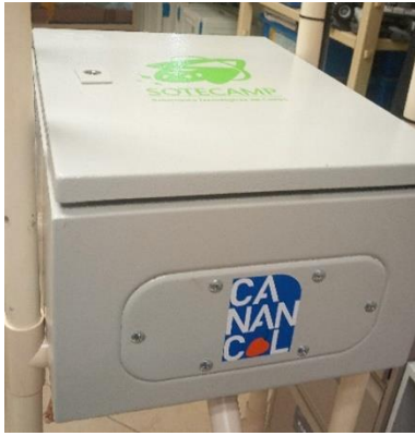
Figura 12 Encapsulado final de circuito en sistema in situ
