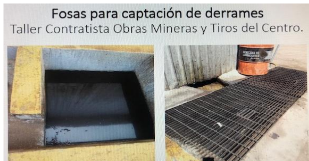
Figura 2 Evidencia de fosas de captación de deshecho industrial
