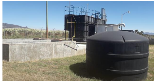
Figura 4 Infraestructura de la planta de tratamiento de agua del CUValles Fuente: Captado personalmente para el archivo de la presente investigación
