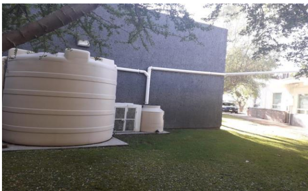
Figura 2 Sistema de Captación de Agua de Lluvia, instalado a un costado del Área de Jurídicos del CUValles Fuente: Captado personalmente para el archivo de la presente investigación
