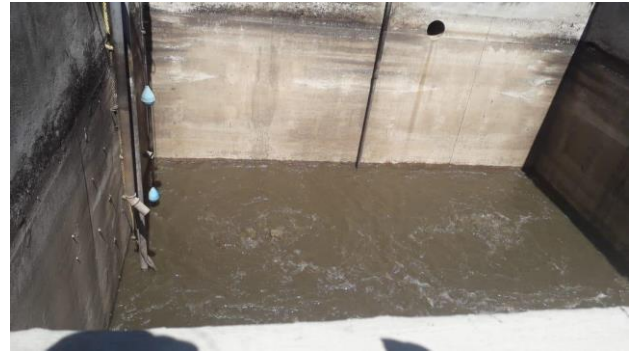
Figura 3 Planta de tratamiento de agua del CUValles Fuente: Captado personalmente para el archivo de la presente investigación
