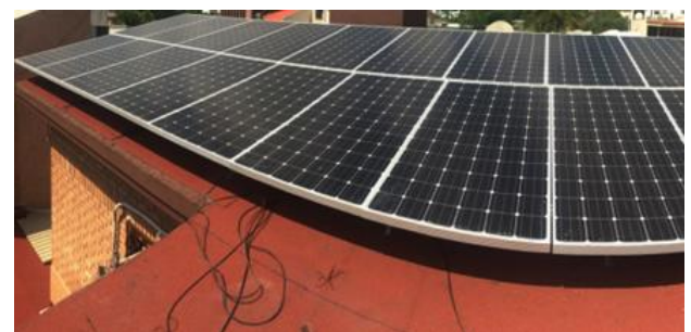
Figura 1 Panel solar fotovoltaico
