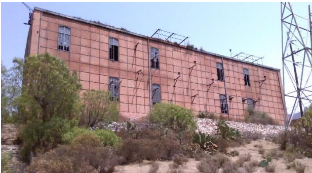
Figura 5 Subestación Eléctrica en Bo. San Guillermo
