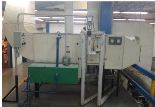
Figura 14 Sistema de acondicionamiento de aire
